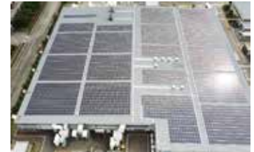
セルメット ® 工場の屋上に太陽光パネルを設置。夏場は、太陽光の輻射熱を反射・遮断し、工場内で、約5℃の温度低下を確認。冬場は、放熱緩和で工場の温度低下を防止し、空調設備の省エネを達成。
